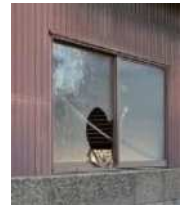
窓が割れた 管理不全空家
